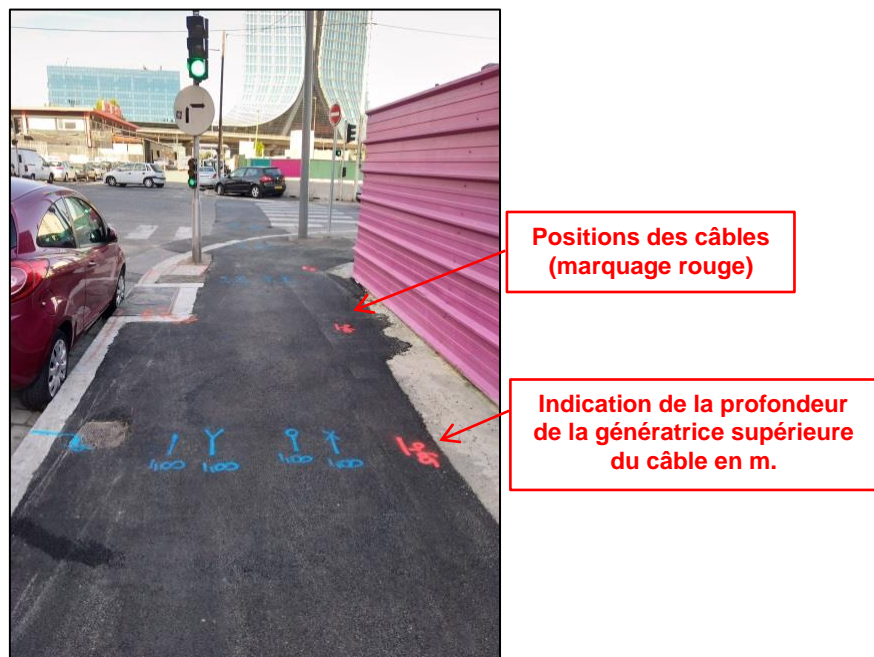
Figures 15 : Matérialisation au sol des réseaux électriques (traits pleins en rouge) avec indication de la profondeur de leurs génératrices supérieures (Ex : 0.70 m).
