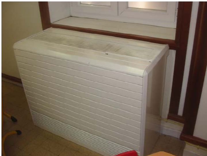
APPAREILS INDIVIDUELS DE CHAUFFAGE A GAZ SUSCEPTIBLES DE CONTENIR DE L'AMIANTE PRESENTS DANS L'ENSEMBLE DU BATIMENT. UNE VERIFICATION SERA NECESSAIRE EN CAS DE TRAVAUX SUR CES ELEMENTS.
