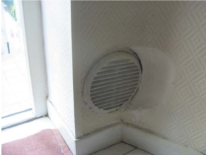
1 CONDUIT EN AMIANTE CIMENT VISIBLE DANS LA CUISINE ETAGE 1
