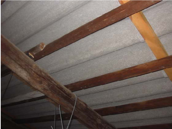
PLAQUES ONDULEES EN AMIANTE CIMENT PRESENTES EN TOITURE.
